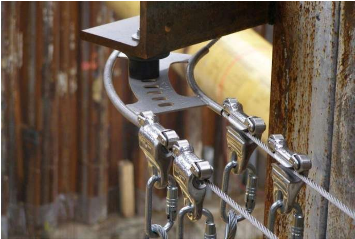
Figura 25. Exemplo de linha de vida horizontal dupla, que permite que um trabalhador passe por outro sem necessidade de se desconectar
